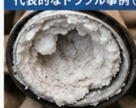
ミキサーパイプの結晶堆積
